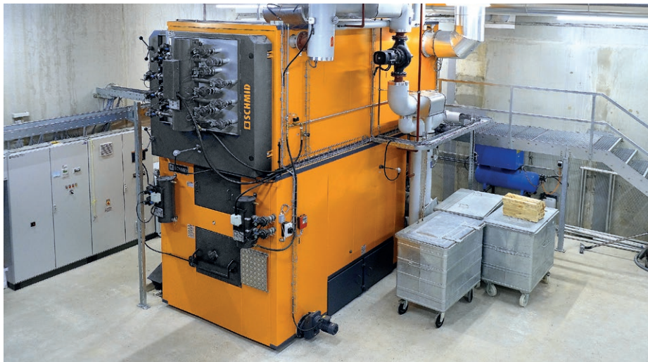
Ein Meilenstein im Geschäftsjahr 2017: Mit der Nahwärmezentrale Steinbach konnte die Energie Belp AG ihr Angebot im Bereich der Wärmeversorgung massgeblich ausweiten.
