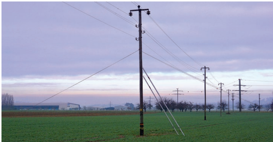
Hier verhinderte ein schnelles Eingreifen Schlimmeres: Burglind hat einem Freileitungsmast im Riedlisacker zugesetzt. Der Pikettdienst konnte ihn stützen, bevor er vollständig geknickt ist.
