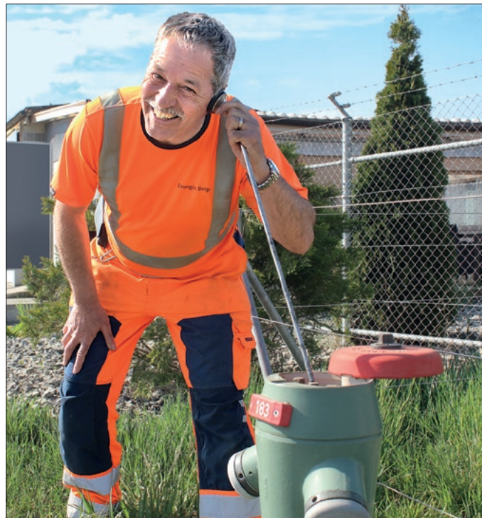
Was rauscht denn da...? Brunnenmeister Bernhard Grossenbacher untersucht einen Hydranten mit einem Hydrophon auf mögliche Lecks. Künftig wird er dabei von einem modernen Überwachungssystem unterstützt.
