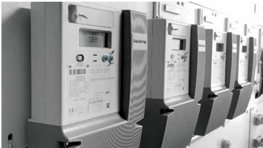
Vernetzte Zählerwelt für die digitale Energieverwaltung der Zukunft: Smart Meter senden Stromverbrauch und Verbrauchszeitpunkt an einen zentralen Rechner des Energieversorgers.
